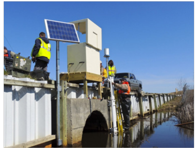
Đội ngũ dịch vụ tại hiện trường của YSI đang hoàn thiện lắp đặt các vị trí quan trắc nước mưa ở Bắc Carolina.
