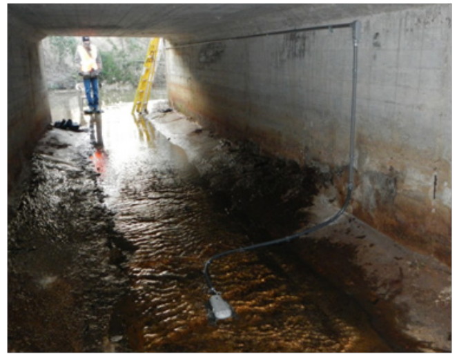
Bộ đo biên dạng dòng chảy bằng siêu âm SonTek IQ acoustic Doppler profiler cho kênh hở/ống không đầy được lắp tại một cống thoát nước mưa
