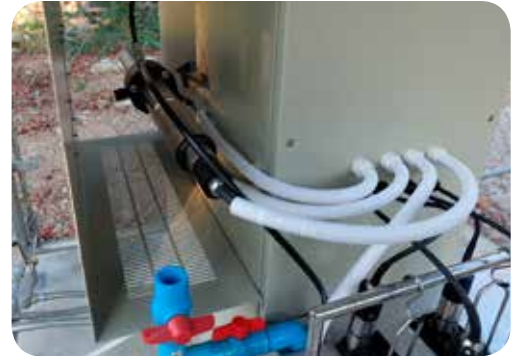
Một cảm biến quang phổ với phụ kiện để nước chảy qua cửa số đo, cũng như hệ làm sạch khí nén bổ sung, được lắp ở phía sau trạm đo.
